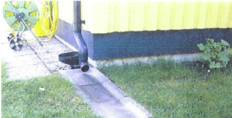
Bild 9: Exempel på stuprörsutkastare för avledning av takvatten till infiltration på gräsmatta. Foto: Mathias de Maré.
