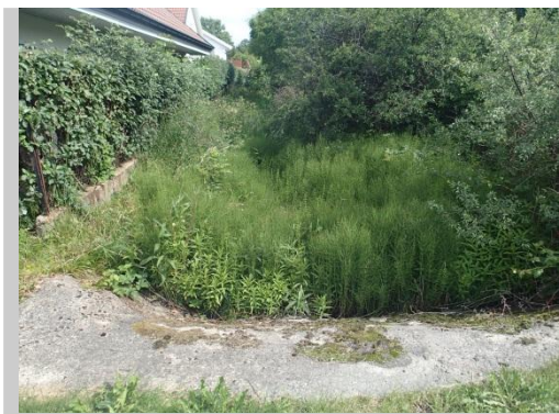
Foto 1: Kulvertering övergår till öppet dike.
